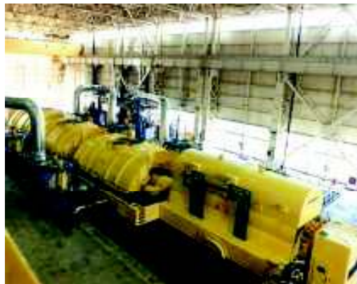
Vedere de Ansamblu Turbina - Generator
