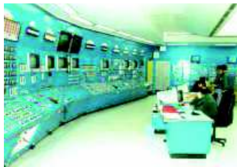
Camera de Comanda Principala a unei Unitati de la CNE Cernavoda
